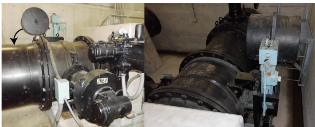
【図1（写真）】 高区調整池緊急遮断弁
